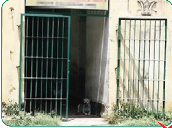
لافتات المدخل رديئة، والمدخل سيء الصيانة
